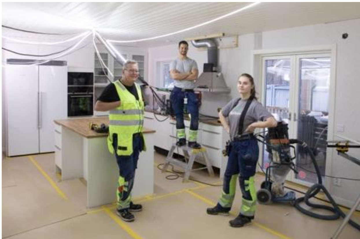
Medarbetare från ByggPartner byggservice under arbetet med att återställa ett brandskadat hus.
